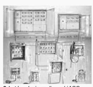
Selectric. Insieme di quadri ASC
